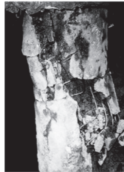
杭頭を剛接した杭の被害例
